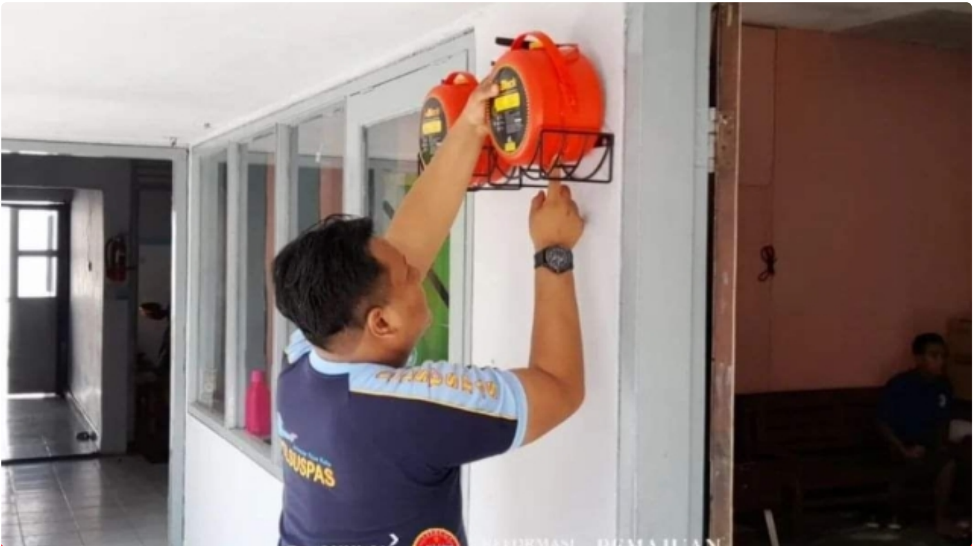
Antisipasi Kebakaran, Rutan Blora Pasang APAR di Titik Rawan
